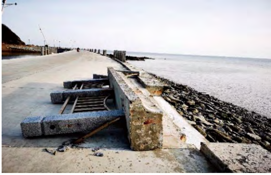
图 8 辽宁省东港市沿海护岸受损
