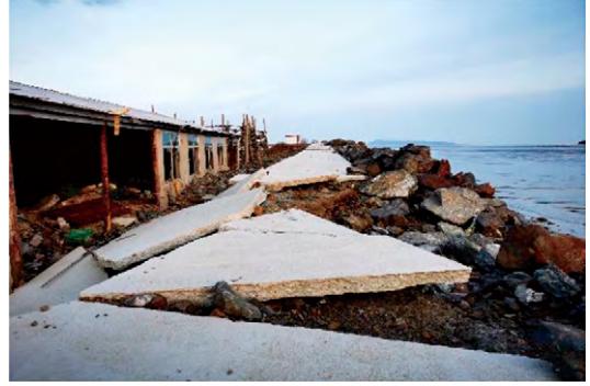
图 9 辽宁省东港市沿海堤防受损
